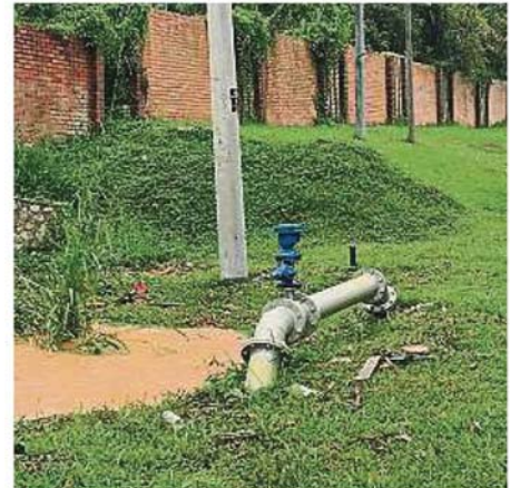
在过去，排水系统不胜负荷，使水沟崩塌成泥坑。
